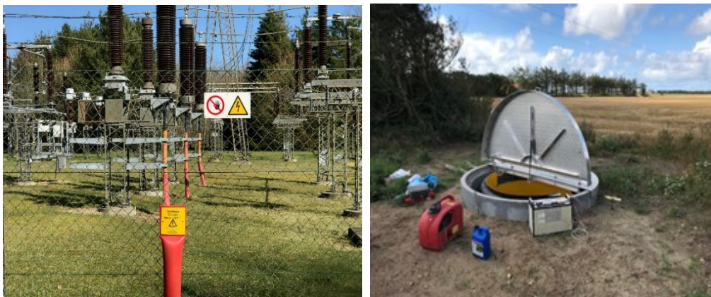
Figur 4.20. Eksempelfoto af markeringspæl og linkboksbrønd
